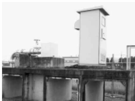
長岡京市水道事業 東16号取水井
