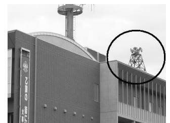
消防新庁舎に新設された防災サイレン
